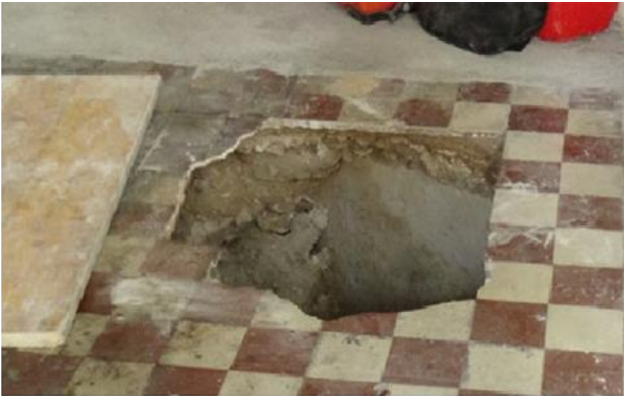
Fig. 11: Cavità apertasi all'interno dell'abitazione
